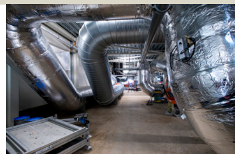
Kæmpe ventilationsrør er et af de tydelige tegn på, at det nye akutcenter ved RH Viborg bygges med fokus på lavt energiforbrug.
